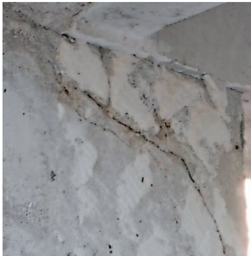
Figura 1 Diverse tipologie di fessure rilevate in corrispondenza dei nodi trave-pilastro.
