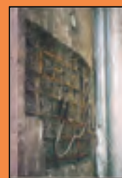
Sensori per il monitoraggio nel tempo dei parametri elettrochimici della corrosione
